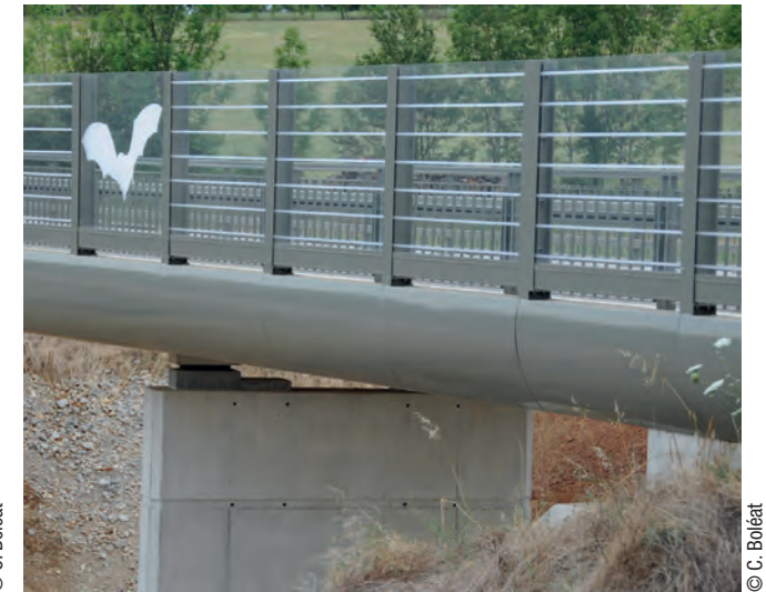
Parapet mis en place pour éviter l'impact des collisions routières sur les chiroptères, Cambes.
