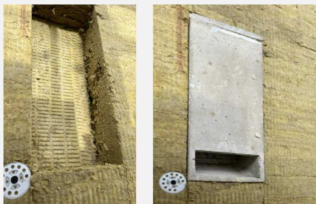
Intégration d'un gîte à chiroptères dans l'ITE avec isolant aminci en face arrière.
