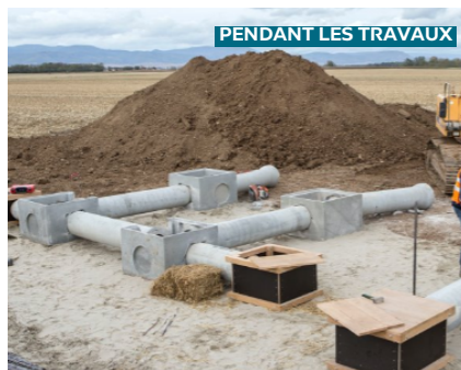
SNCF Réseau Grand Est
